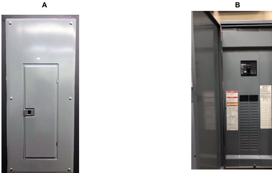
Figura 4 – Centros de carga interiores y exteriores (ejemplos)
