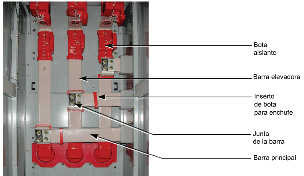
Figura 26 - Barra principal (sin la cubierta de la barra posterior)
